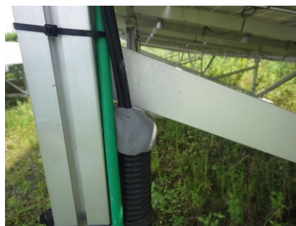
各種配線貫通部のシール
